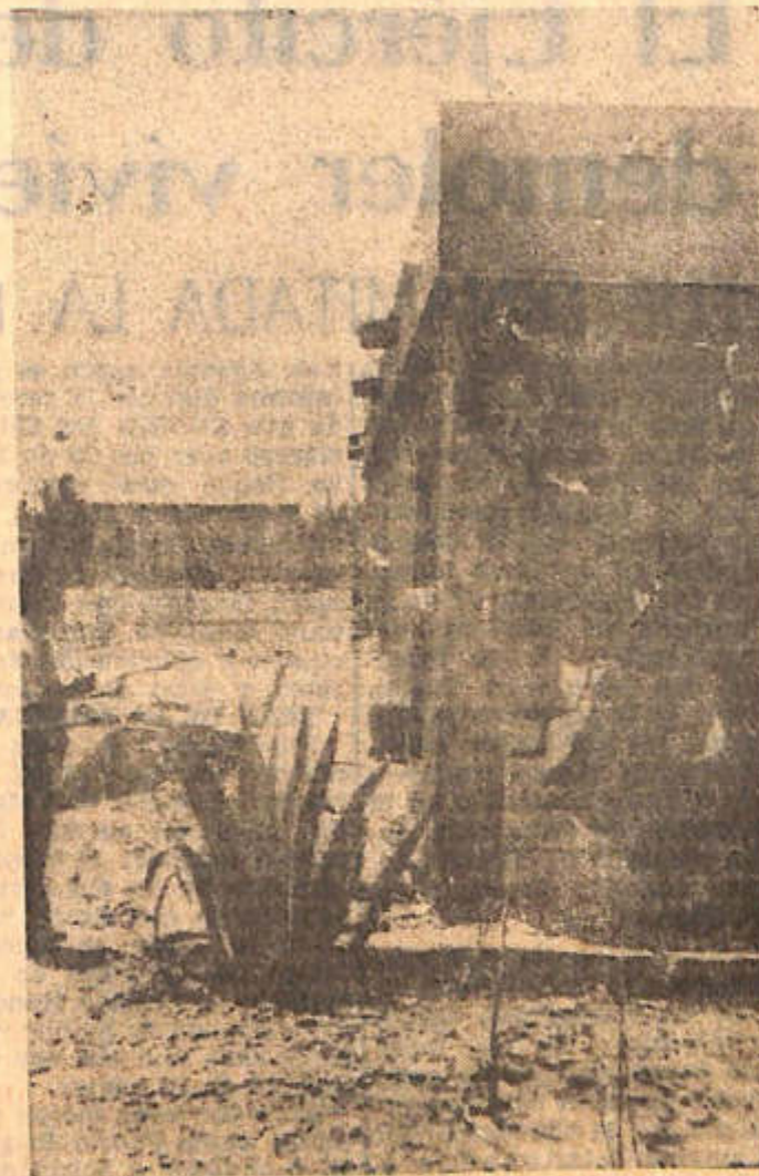
Armaduras deterioradas y revoques destruidos en el nuevo edificio de la escuela nacional 17, de Angaco, construido hace 5 años. El terremoto del 23 en aquella zona, alcanzó el grado 8 a 9 en la escala Mercalli modificada.
