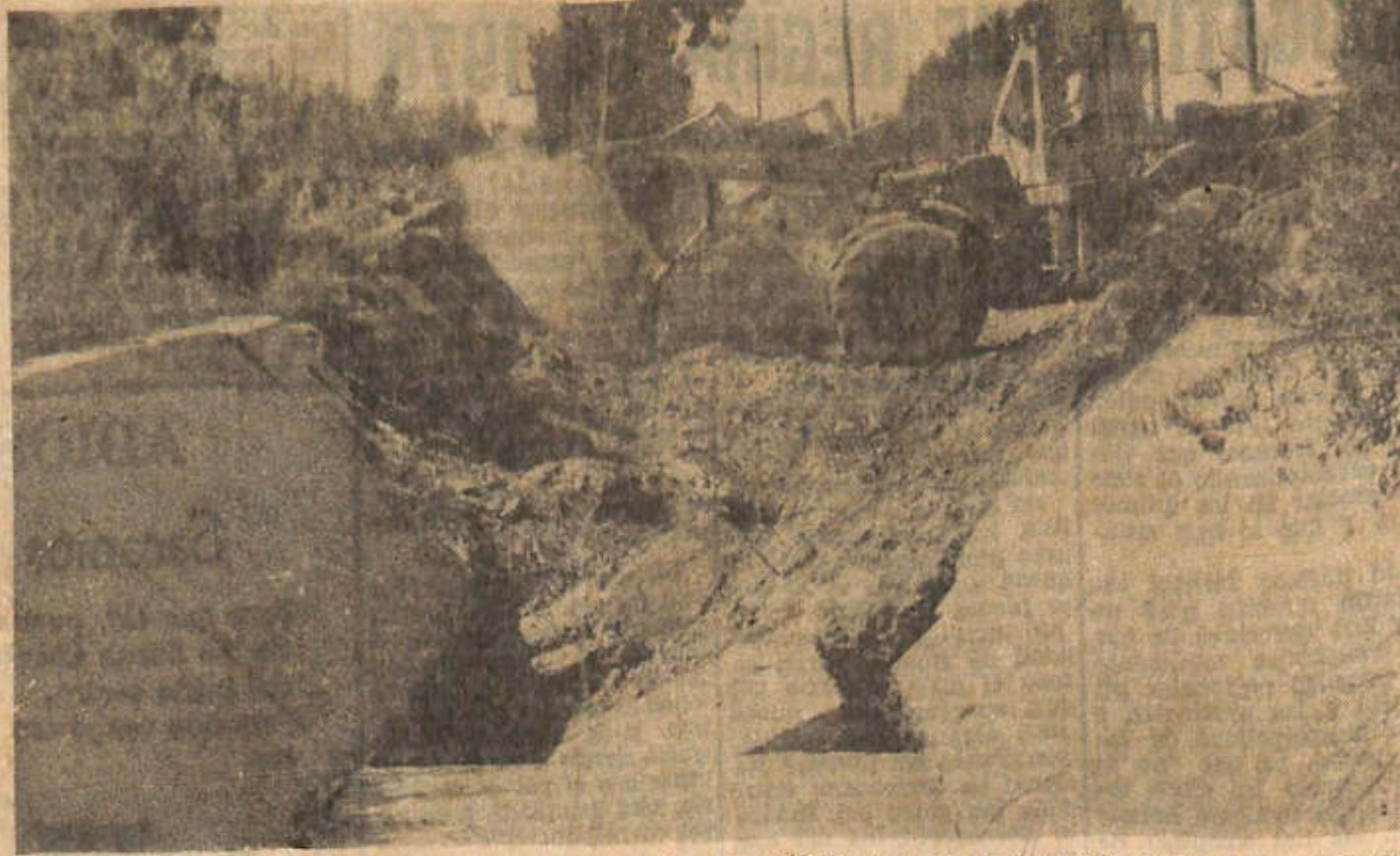
DAÑOS CUANTIOSOS. Como el que se aprecia en la nota gráfica, provocó el terremoto en las redes de irrigación y drenaje. Se estima que los trabajos de reparación insumirán mil millones de pesos.
