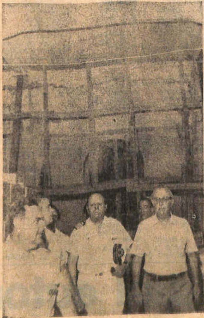
El gobernador de la provincia, en compañía del jefe del Regimiento 22, y el doctor Lamón, inspeccionan los daños ocasionados en el segundo piso de la vieja estructura del hospital Rawson.
