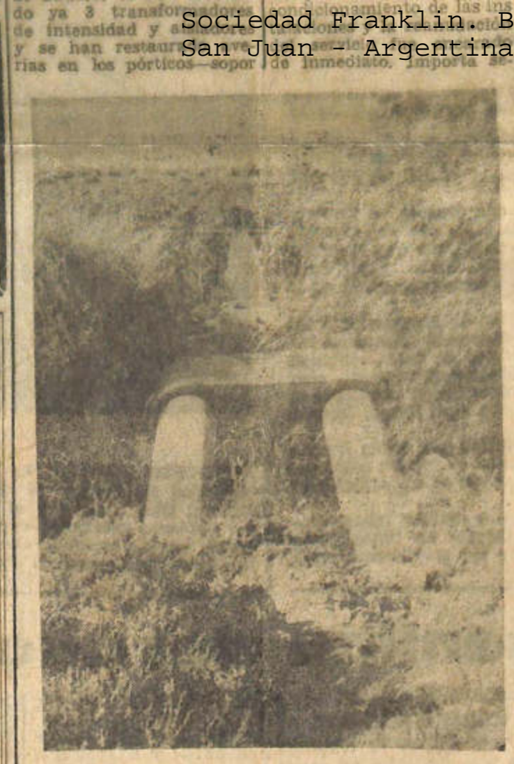
Una de las estructuras caídas de la línea de alta tensión de 132 kv, que desde San Juan alimenta a la E. T. Cauçete. Daños como este provocaron su momentánea inutilización, lo que fue conjurado con conexiones de emergencia.
