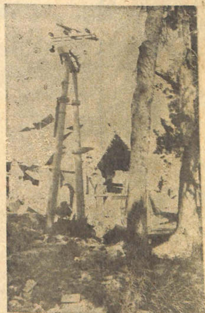
Estado en que quedaron una de las subestaciones de Agua y Energía Eléctrica, y la bodega del Parque, en Caucete, y que debe ser reconstruida.
