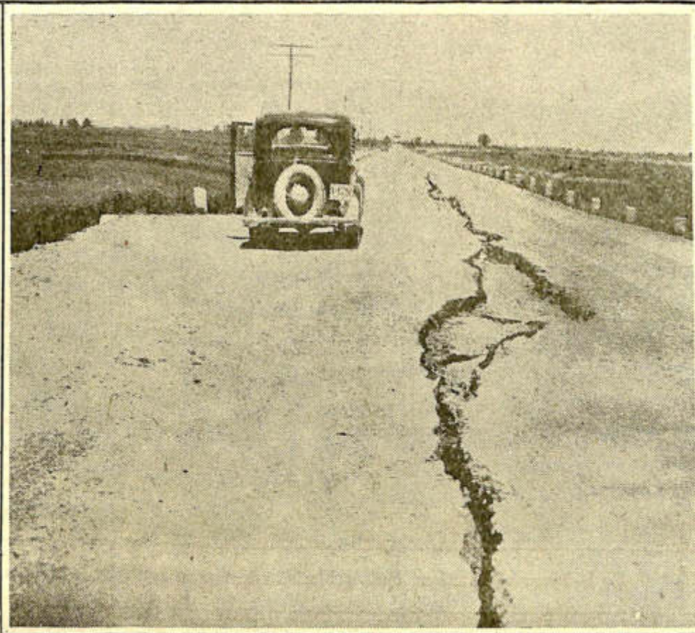
Grieta producida por el sismo en el camino de San Juan a Caucete, cerca del puente Nueve de Julio
